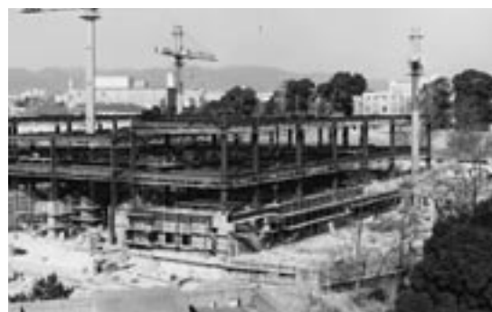
17 鉄骨が組み上がっていく建設中の総合図書館 （昭和58年11月）
